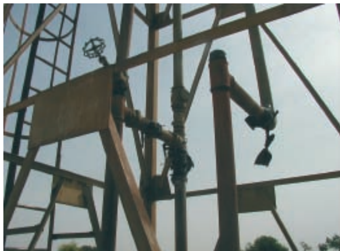
Photo 13 Base d'un réservoir avec tuyauterie entrée et sortie
