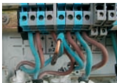
Photo 35 Câble mal serré qui a provoqué un échauffement local
