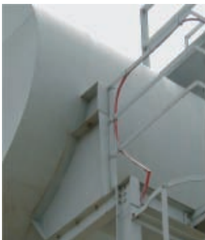
Photo 16 Câble électrique mal fixé
