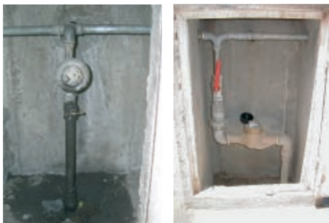
Photo 27 et 28 Compteurs de bornes-fontaines à jet unique en position verticale et à jets multiples en position horizontale. On peut noter le soin apporté pour éviter trop de perte de charge au niveau du té sur la photo de droite
