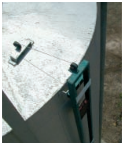
Photo 15 Indicateur de niveau
