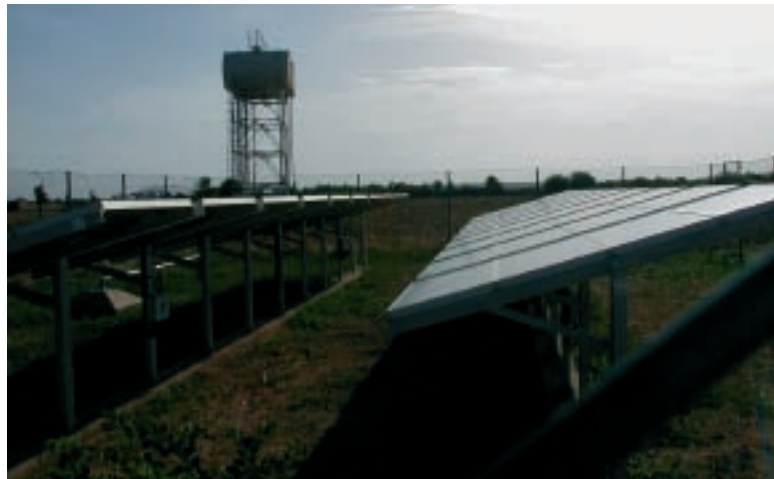
Photo 4 Pompe solaire de 4 Wc
